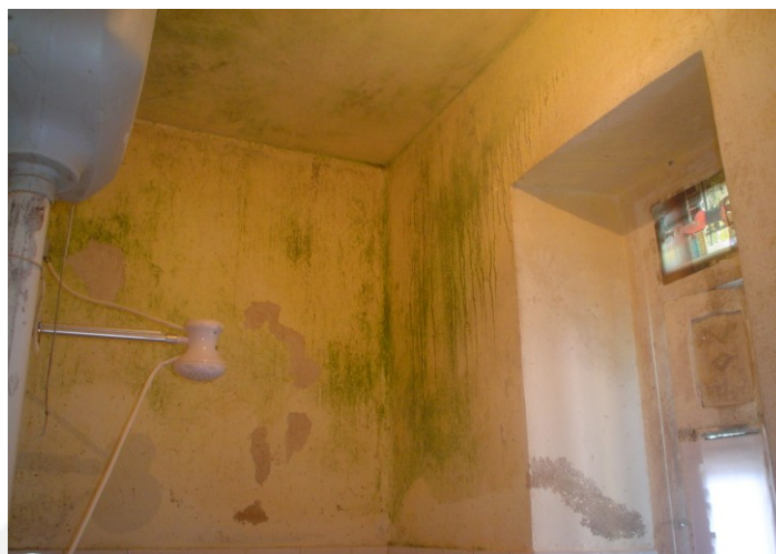
Figura 1: Banheiro com paredes contaminadas por fungos.
