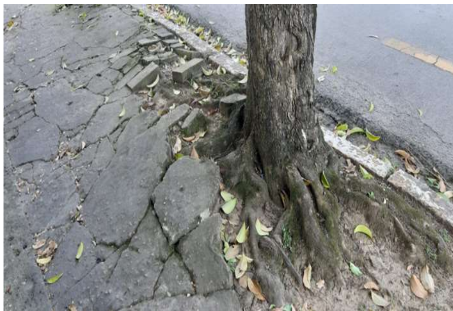
Figura 5 - Calçada danificada pela arborização inadequada
