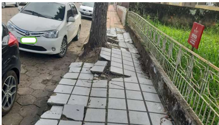
Figura 3 - Calçada desnivelada e com ausência de piso tátil
